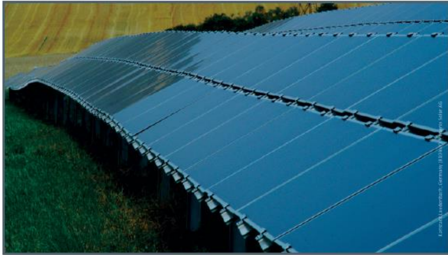
Slika 3. Energetsko postrojenje u ruralnoj Njemačkoj [2].
