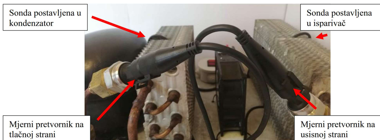
Slika 28. Postavljanje mjernih pretvornika i sondi
